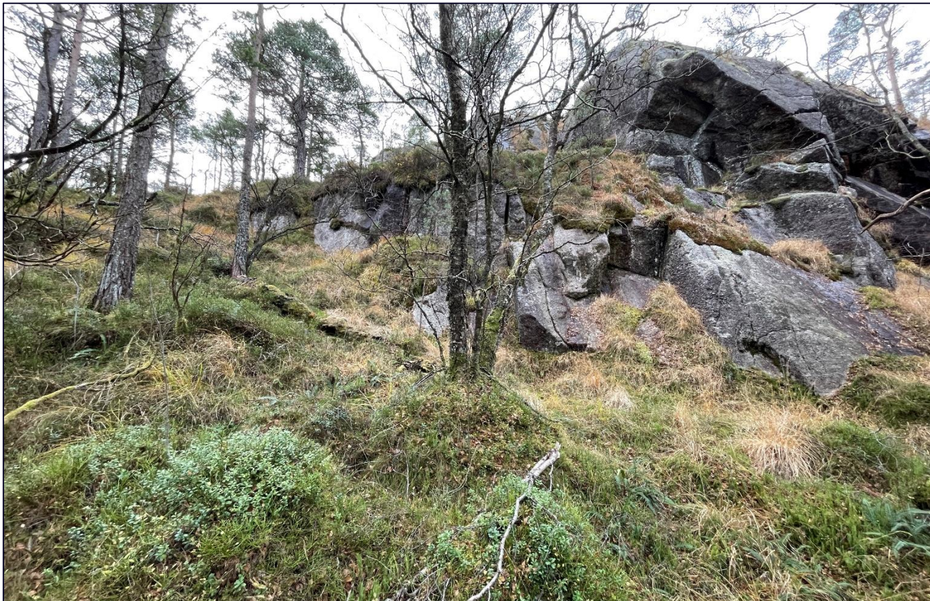
Figur 29 Bilde 7 er tatt nord i tiltaksområdet, i nærheten av hvor det skal anlegges ny tursti. Det er noen skrenter med bart fjell i dagen her, men fjellet fremstår massivt og med lavt løsnepotensiale for steinsprang. Bilde av Skrið
